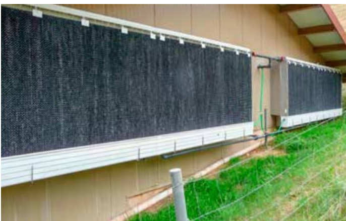
Bei einem Cool Pad wird die Zuluft mithilfe von kaltem Wasser gekühlt.
