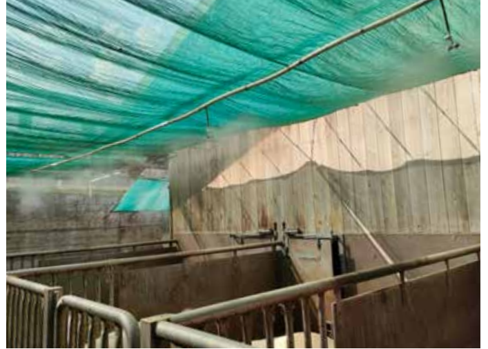
Mithilfe einer Niederdruckbenebelungsanlage können die klimatischen Bedingungen für Schweine optimiert werden.
